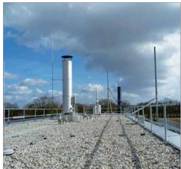
Gasentsorgung über die Notfackel.
