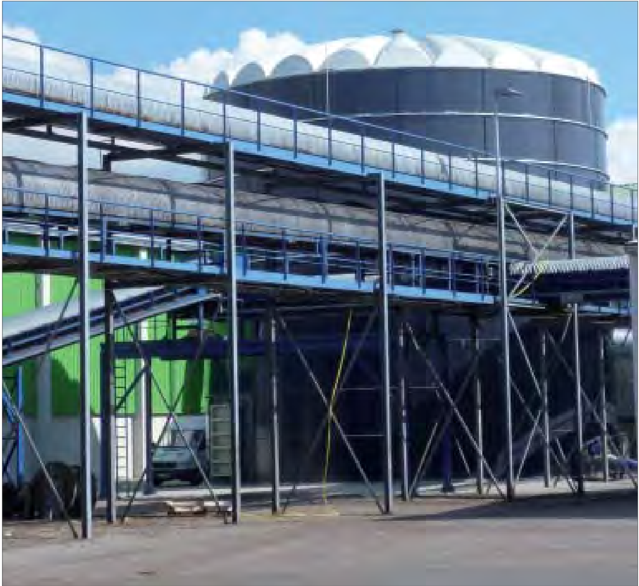
Flüssigdüngerspeicher der Vergärungsanlage.
