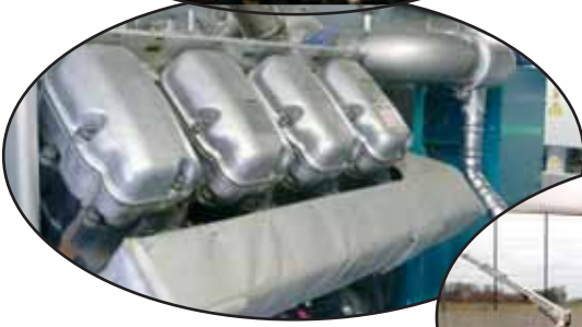
Verstromung von Biogas
