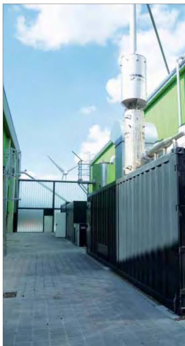
Blockheizkraftwerk (BHKW) für die Verstromung des Biogases.
