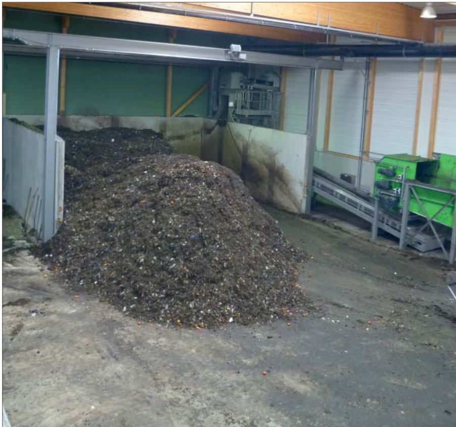
Vergärungshalle mit Vorlage- und Konditionierungsbox
