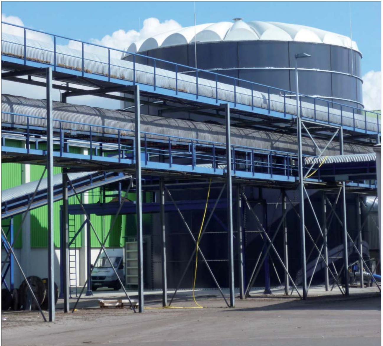
Flüssigdüngerspeicher der Vergärungsanlage
