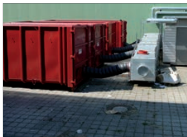
Containertrocknungsanlage für Biomasse
