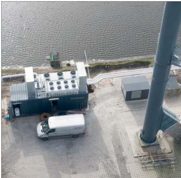
Zusätzliches BHKW mit Trafo
