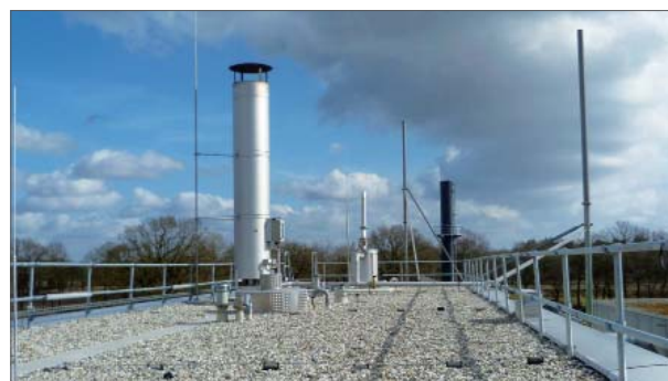
Gasentsorgung über die Notfackel
