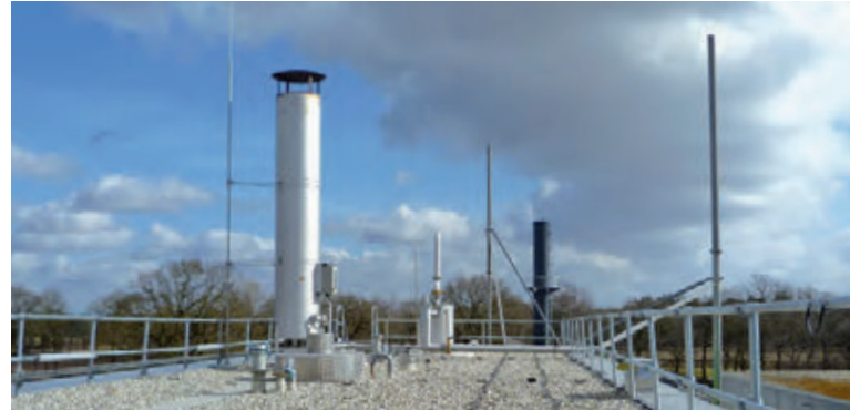
Dach des Fermenters mit Blick auf Notfackel
