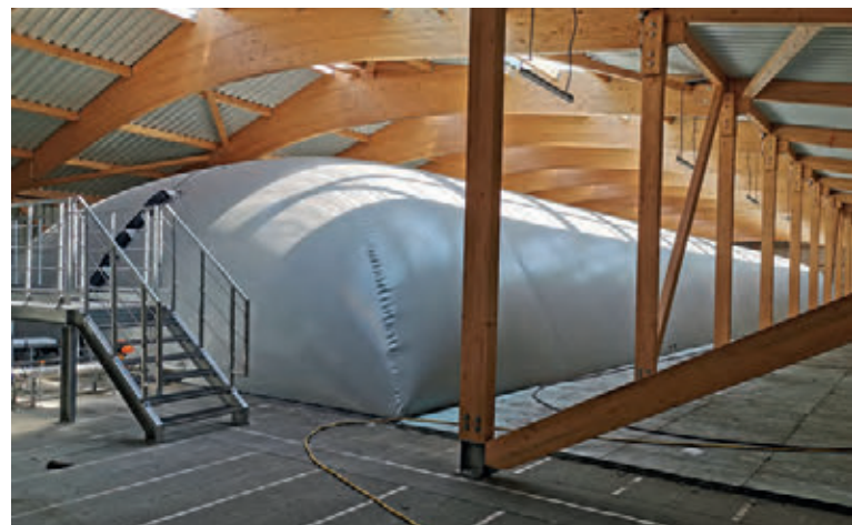
Biogasspeicher unter dem Dach der Bioabfall-Kompostierungsanlage
