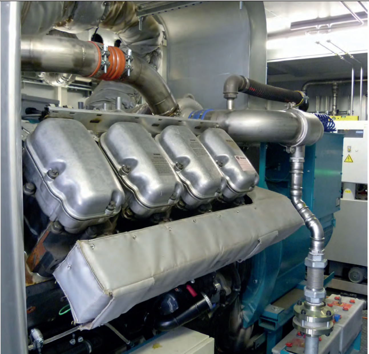
Der Motor ist das Herzstück des BHKW
