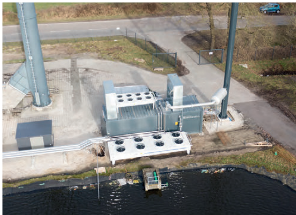
Neu errichtetes drittes BHKW mit 525 kWel
