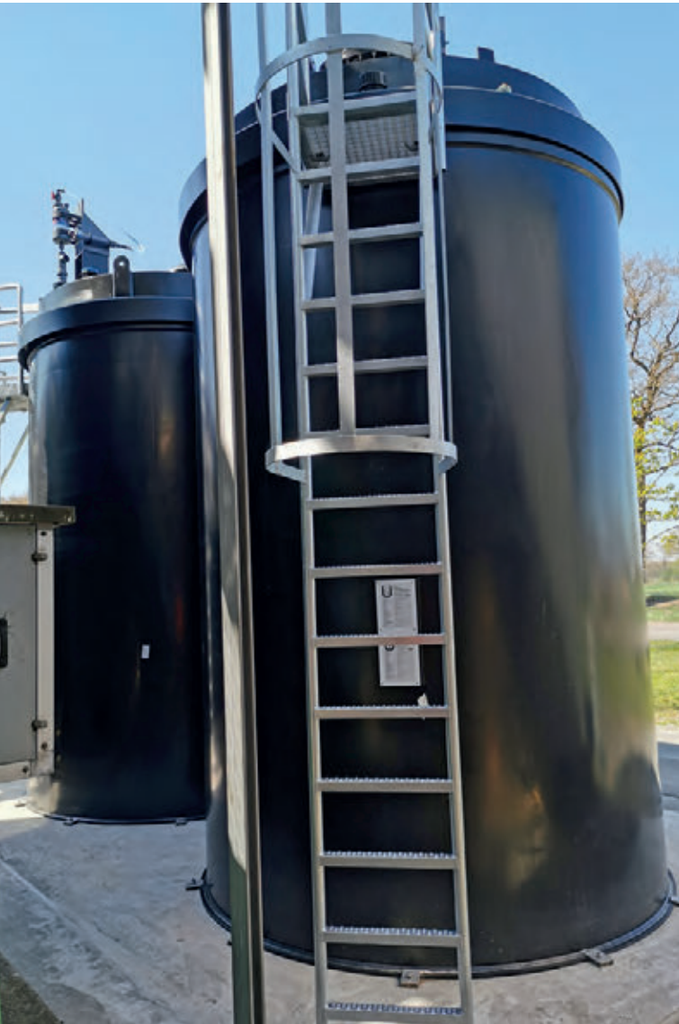
Neu errichtete Lagertanks für Ammoniumsulfat-Lösung und Schwefelsäure
