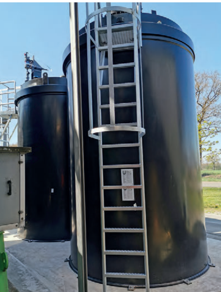
Lagertanks für Ammoniumsulfat-Lösung und Schwefelsäure
