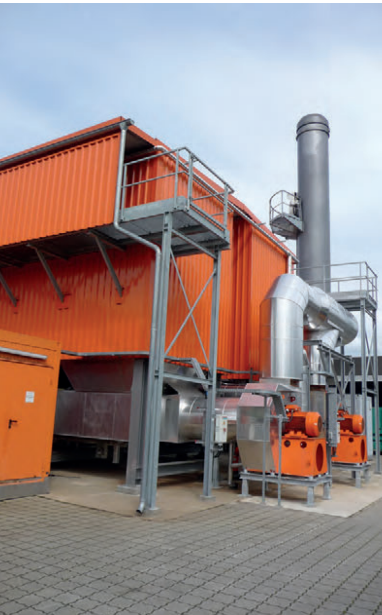
RTO zur Abluftbehandlung und Deponiegasverbrennung
