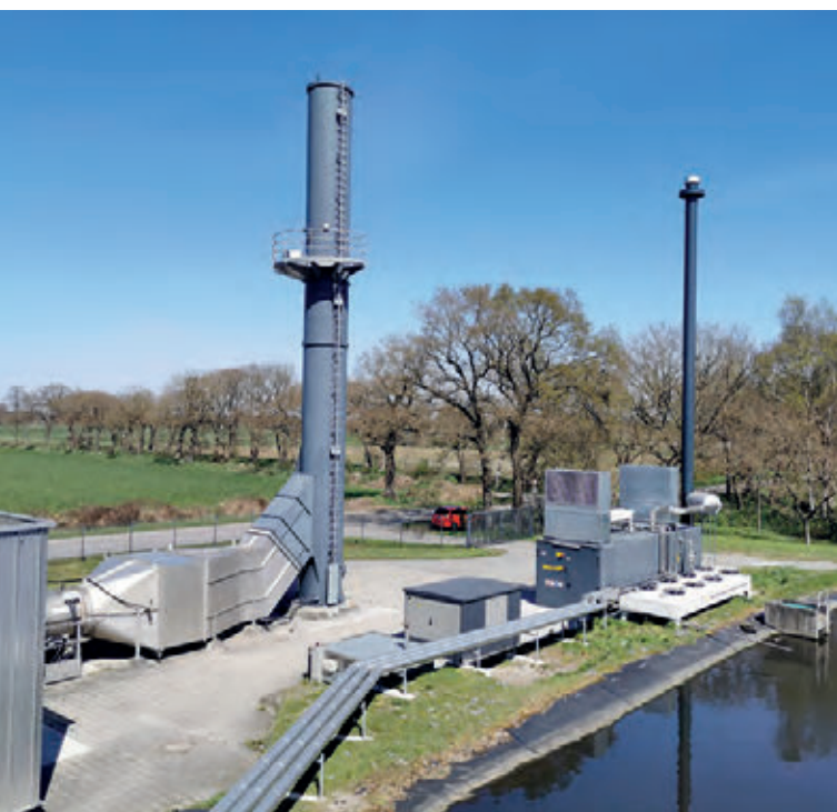
BHKW 3 mit einer elektrischen Leistung von 525 kW
