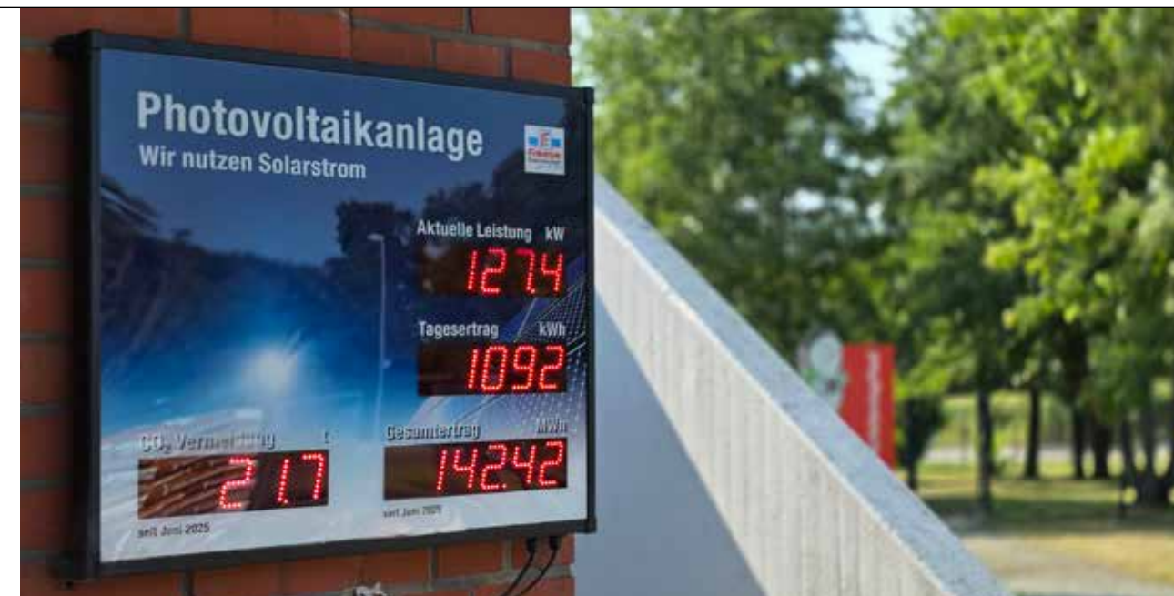
Ertragsanzeige der PV-Anlage Halle West
